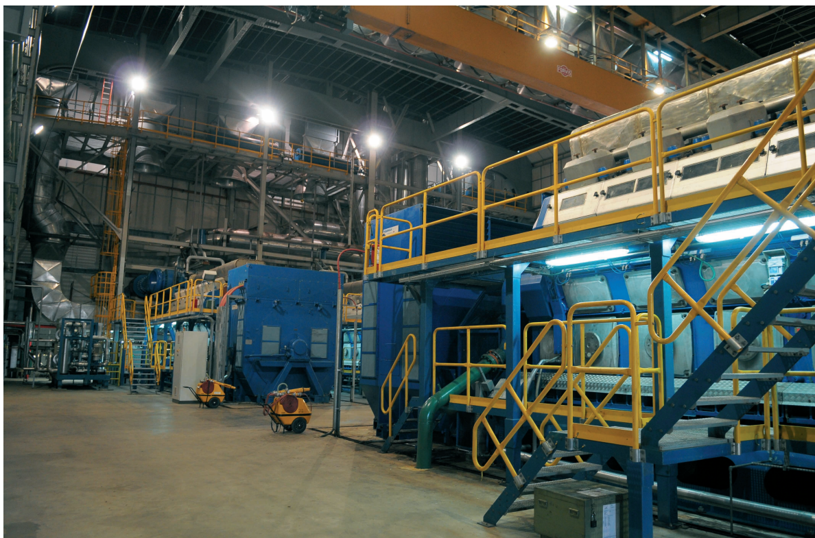
Motores Wärtsilä42 de 80MW puesto funcionamiento durante el 2009 en la Central Battle, Montevideo, Uruguay
